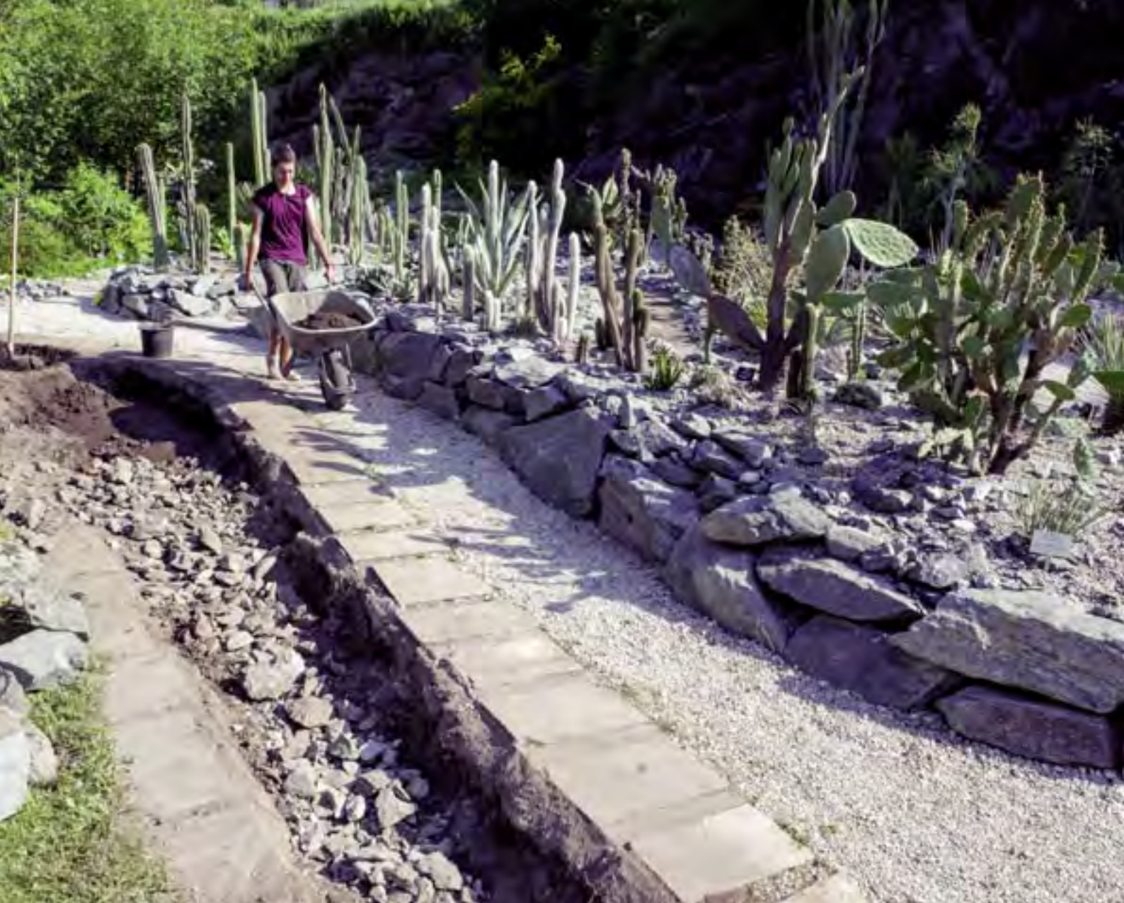
Abb. 7: Abtransport des Aushubs durch Daniel Luttenberger und Einbringung einer Dränageschicht für den neuen Teil des Quartiers für Sukkulente aus der Neuen Welt. Aufn. R.K. Eberwein
