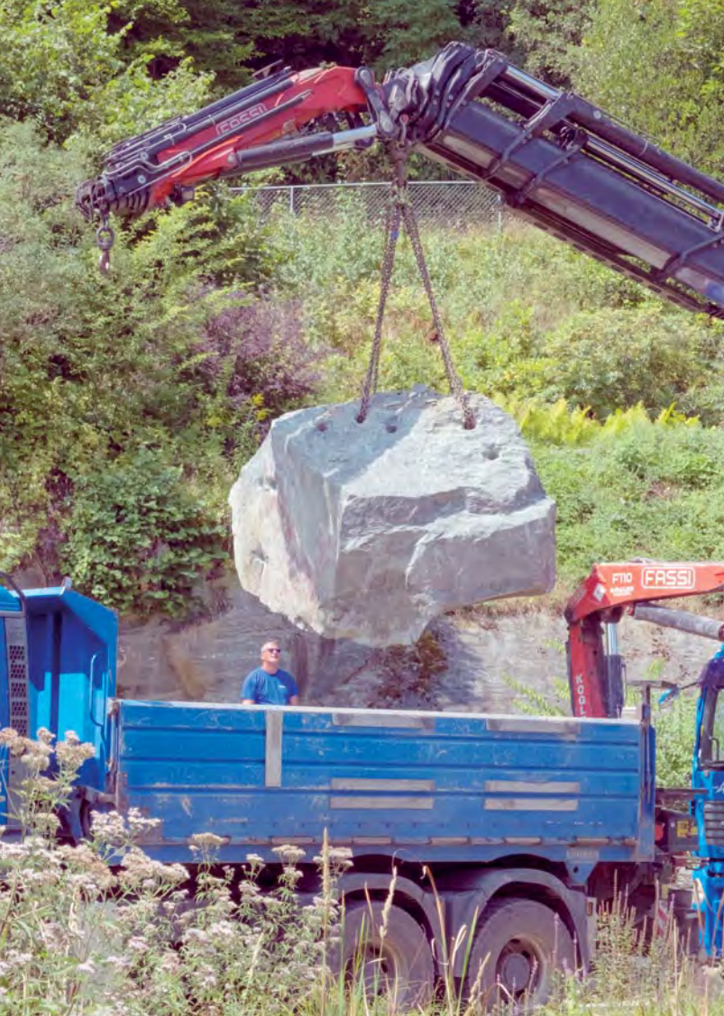
Abb. 2: Abtransport eines großen Felsbrockens, der aus Sicherheitsgründen entfernt werden musste. Aufn. LMK-KBZ Roland K. Eberwein
